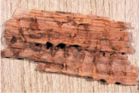
Fig. 8a. Moisture ant damage.
